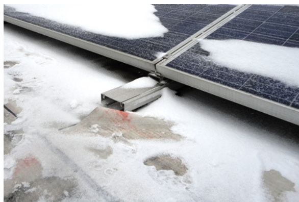
schade aan waterdichting door onvoldoende schuifweerstand (foto WTCB)
