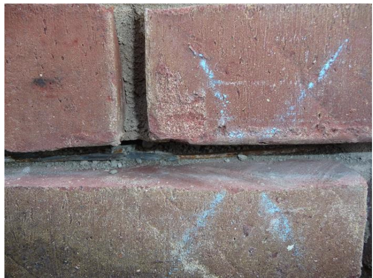
roestvorming op gegalvaniseerd stalen metselwerkwapening , één jaar na uitvoering
